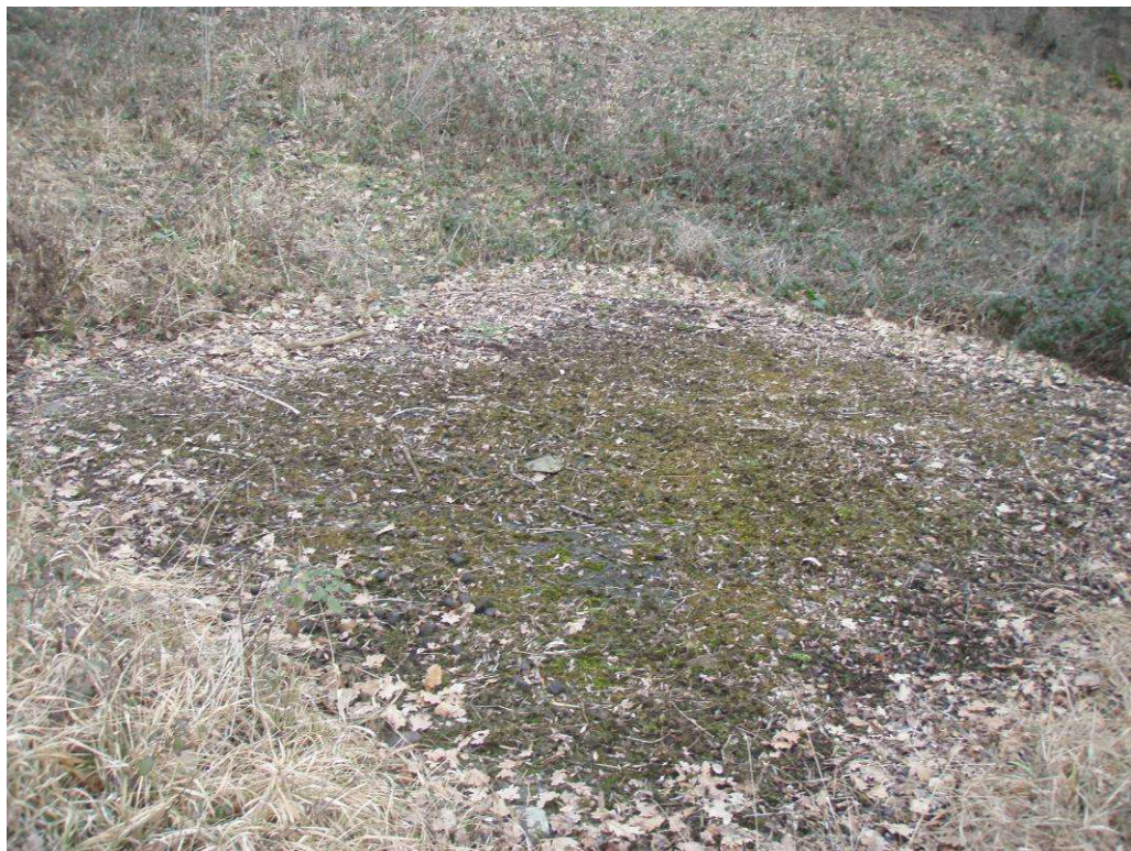
Photo 4 : dalle béton sur la tête du puits Brachet Sud (concession de Givors et Saint-Martin de Cornas).
