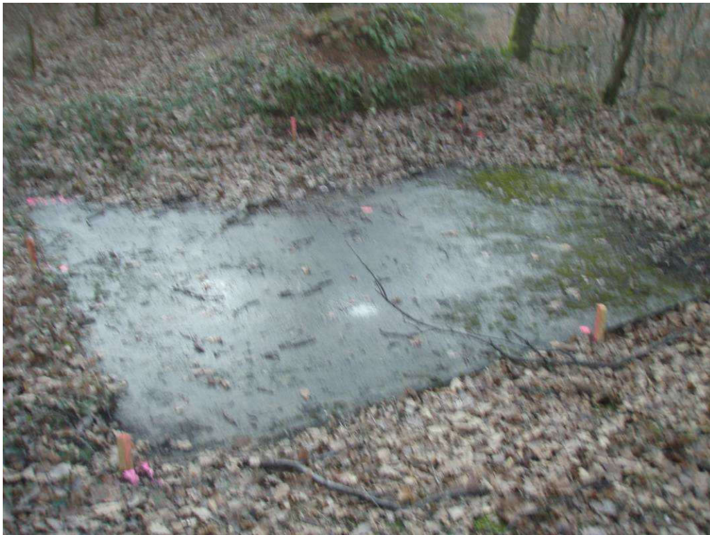
Photo 2 : dalle béton sur la tête du puits Henry (concession de La Forestière et Fontanas).
